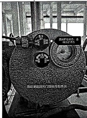
图 2、微过滤超越闸现场控制单元
