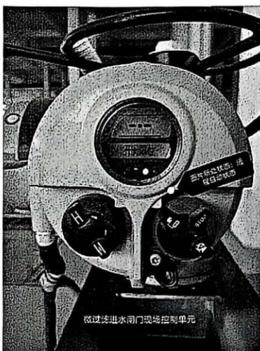
图 3、微过滤进水闸现场控制单元
