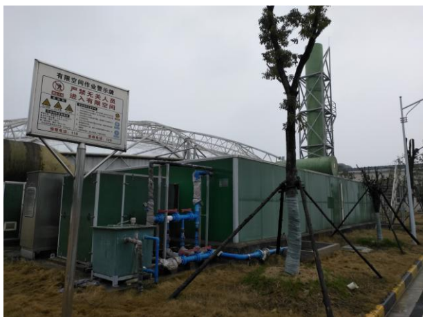
污水处理区除臭系统排气筒
