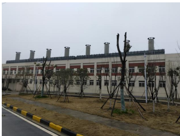
污泥好氧发酵车间除臭系统排气筒（暂停使用）
