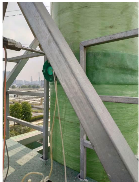
A 区生物池除臭系统出口（◎3-2）
