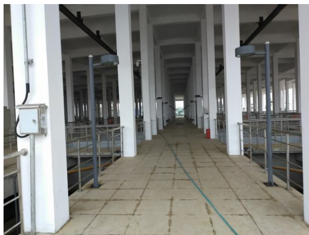
高效沉淀池（内部）
