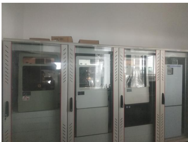
图 4-1 废水在线监测系统
