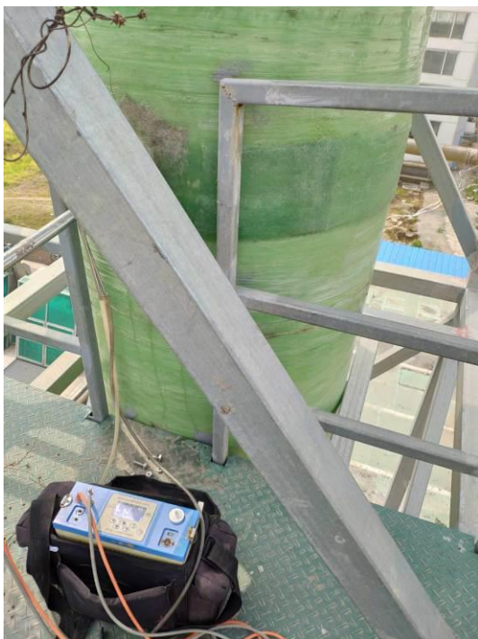
格栅除臭系统出口（◎2-2）
