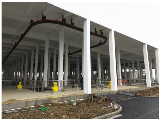
高效沉淀池（外部）
