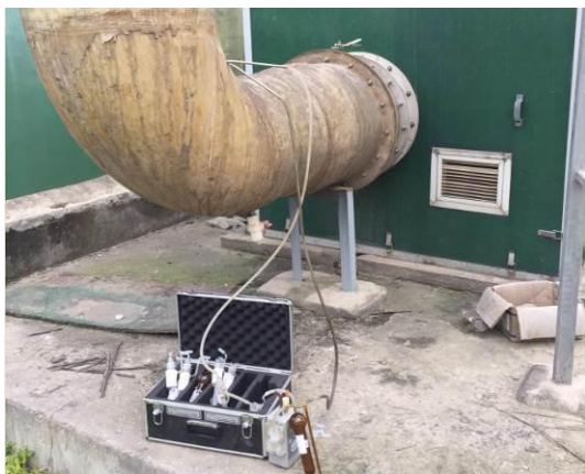
A 区污泥浓缩除臭系统进口（◎1-1）
